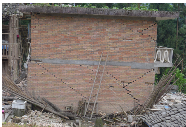
图 2c 双石镇未垮塌的房屋墙壁上均出现两组张性的 X 节理, 钝角方向对着垂向
